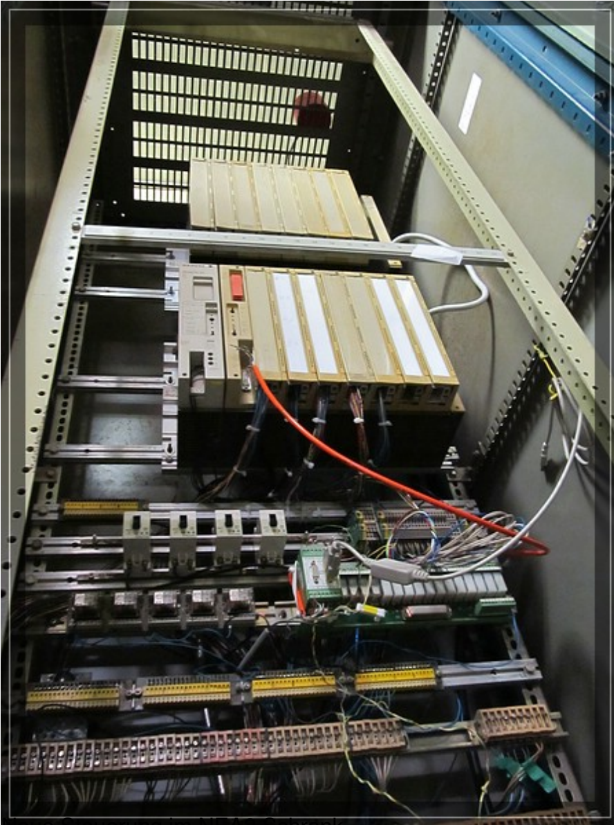
Neue Steuerung im NEAZ Schrank
